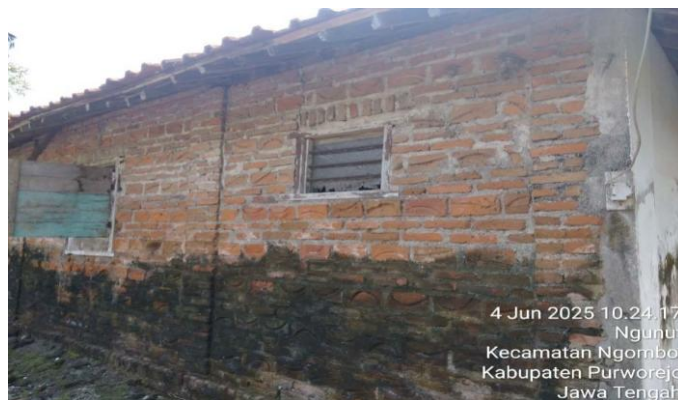
Gambar 4. Bangunan Dengan Kondisi Dinding yang Retak
