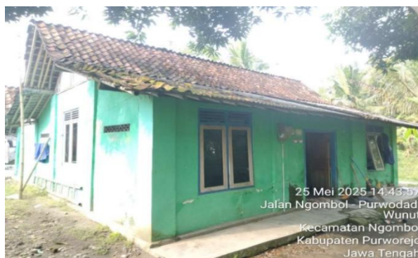
Gambar 8. Penutup Atap yang Rusak
