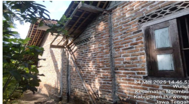
Gambar 3. Bangunan Tanpa Struktur Utama
