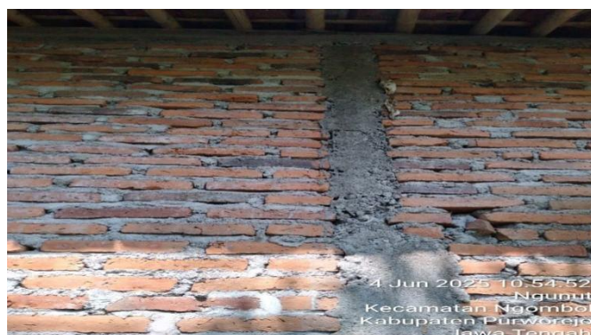
Gambar 5. Bangunan Dengan Kondisi Kolom Keropos
